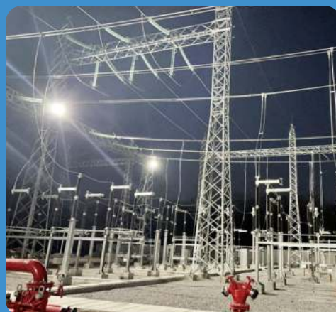
Công trình Trạm điện biến áp 220KV Long Khánh (Đồng Nai) - Dự án cung cấp Thiết bị an ninh giám sát, báo động chống trộm
